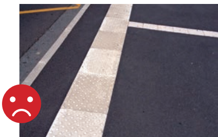
Dalles podotactiles en béton lisse: noircissement rapide, apparition de variations de teintes, risque de glissance non conforme.
