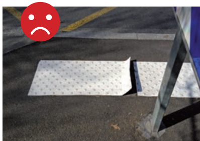
Dalles podotactiles plastique: risque de décollement rapide, de chute ou de non détection danger
