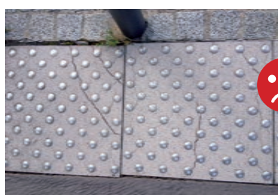
Dalles podotactiles « SMAC » en bitume et inox: apparition de fissures lors de variations de température.
