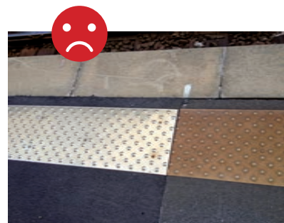
Plaques podotactiles vissées en inox: apparition rapide de corrosion.
