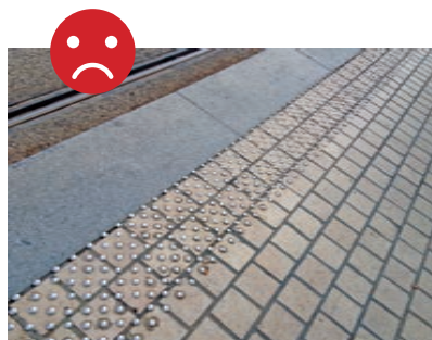
Clous podotactiles inox: risque important de non détection de danger. Contraste visuel non conforme.
