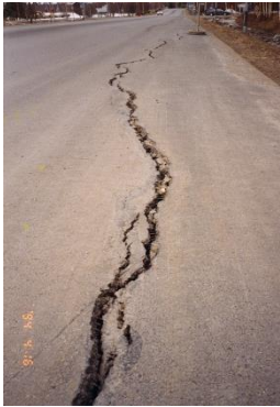
Fissuration en long
