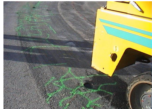
Micro-fissures peintes en vert pour visualisation à 1 million de charges
